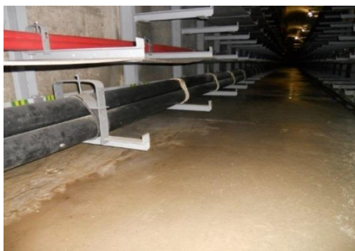
Obrázek 9: Kabely v kolektoru
