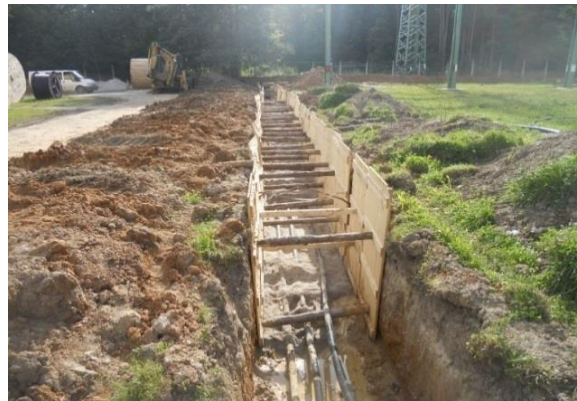
Obrázek 4: Kabely uložené v zemi
